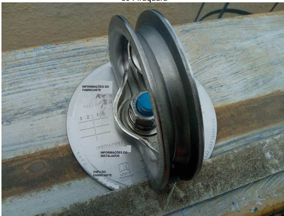
Imagem 3 - Disco de Identificação de Ponto de Ancoragem Instalado- Fórum Eleitoral de Piraquara
