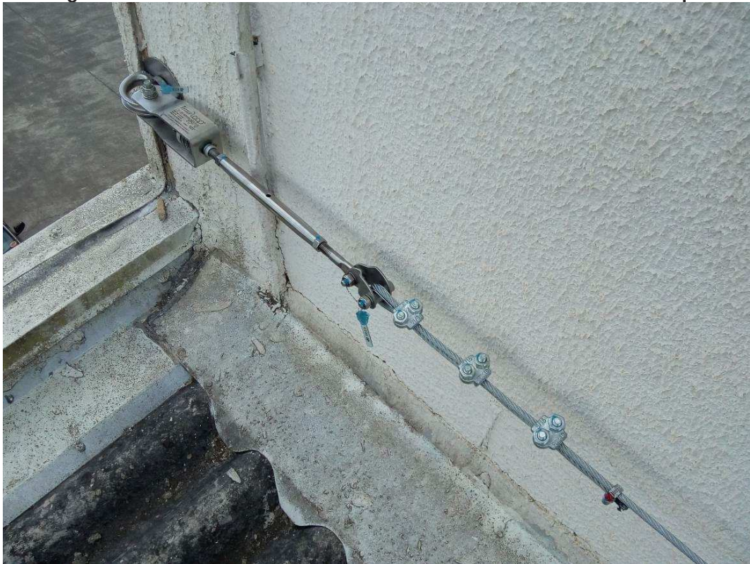
Imagem 5 – Tensionador e Indicador de Tensão - Fórum Eleitoral de Piraquara
