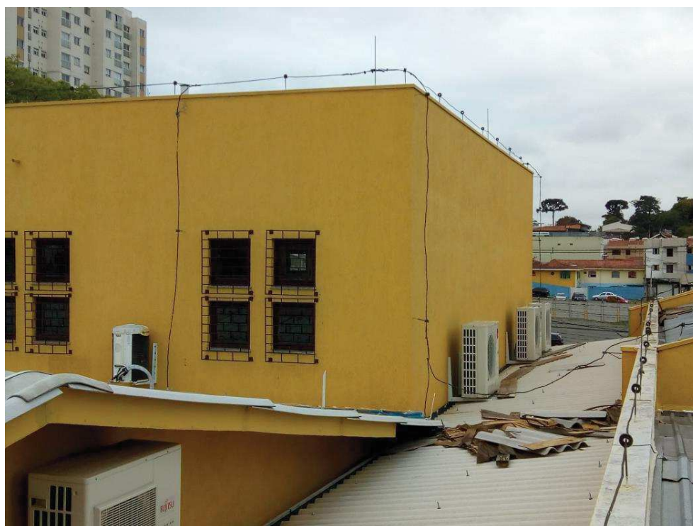
Imagem 4 – Parede externa Depósito de Urnas – São José dos Pinhais – Situação anterior à execução do sistema de proteção contra quedas.
