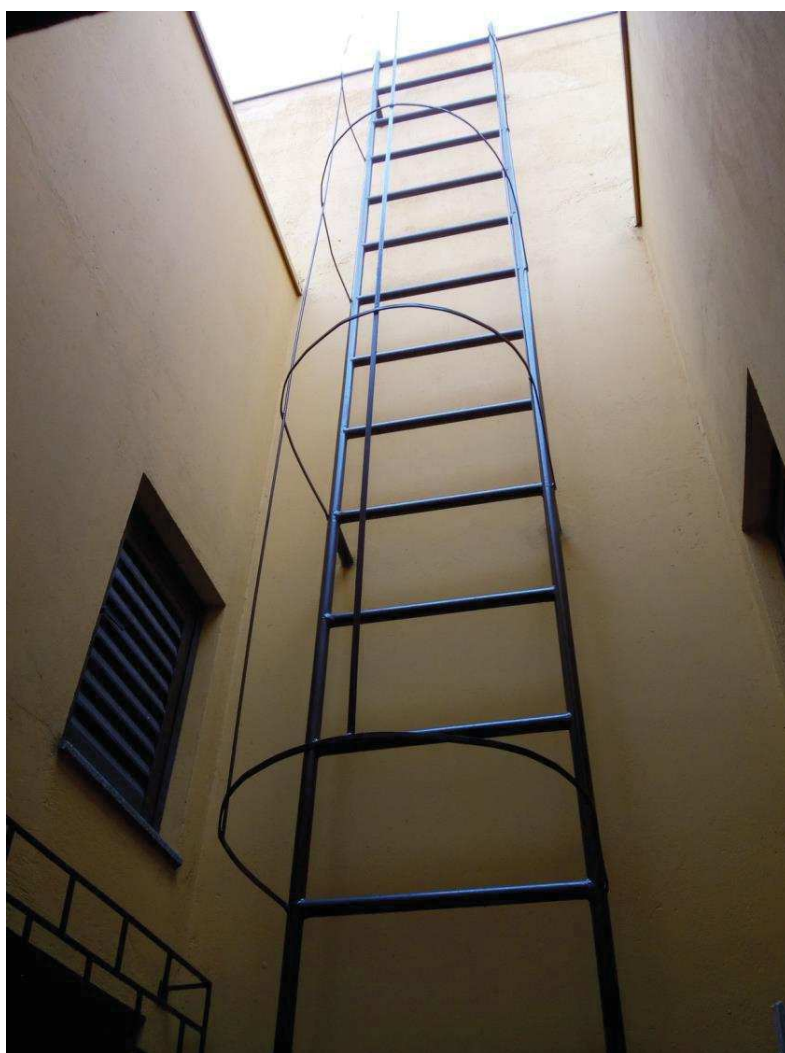
Imagem 2 – Escada de acesso – Paranaguá – Situação anterior à execução do sistema de proteção contra quedas.
