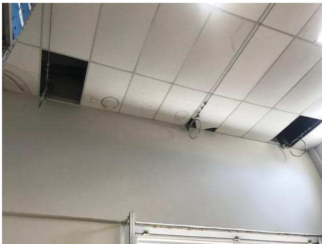
Imagem 14 – Instalação de ancoragens internas com suporte invertido, fixação em viga acima do forro.
